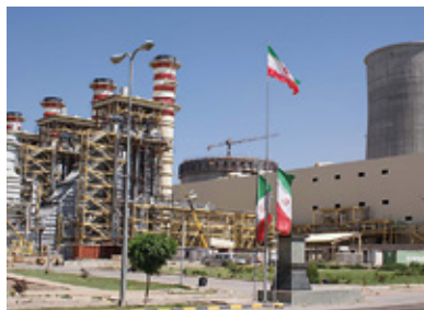
Gaskombiverk (CCGT) i Iran.
